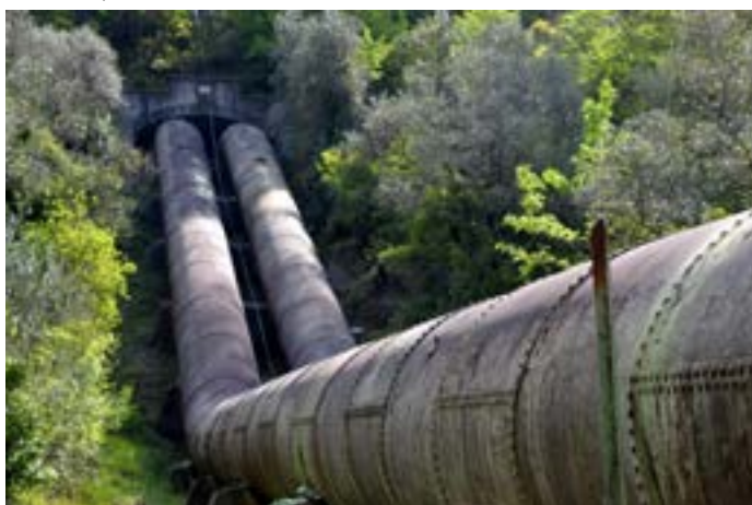
Vue de la conduite forcée dans la pente en rive gauche, face à la centrale de Piène-Basse. (cliché © Patricia Balandier)
