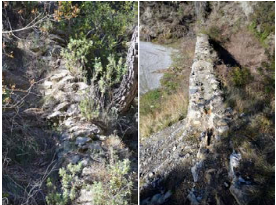
Vue de détail du rampant descendant du pont-siphon de Piène-Haute. Une maçonnerie grossière protège la conduite en terre cuite. (cliché © Patricia Balandier)
