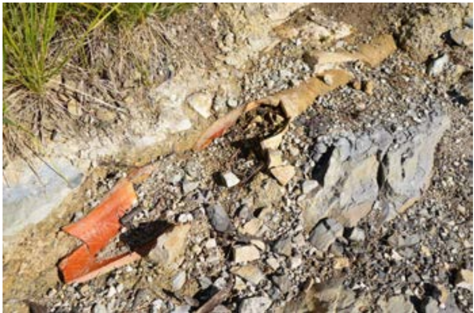
Manchons de terre cuite à emboîtement du pont-siphon de Piène-Haute sur un tronçon endommagé. (cliché © Patricia Balandier)
